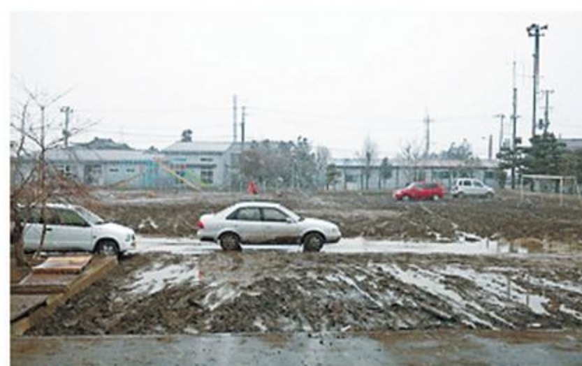
液状化した小学校の校庭
